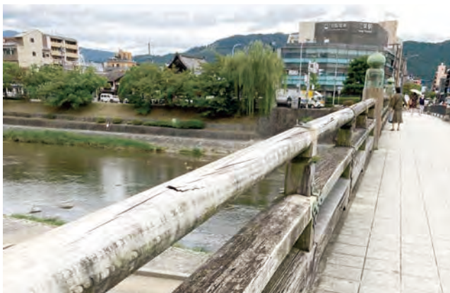
損傷の進む三条大橋
